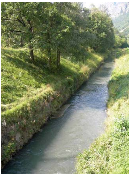
Canal de drainage
