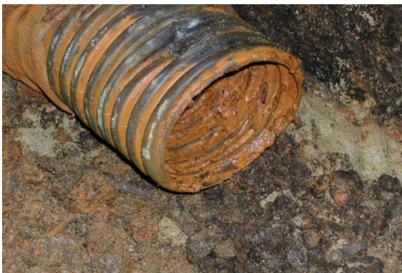
Colmatage ferrique des orifices d'un drain
