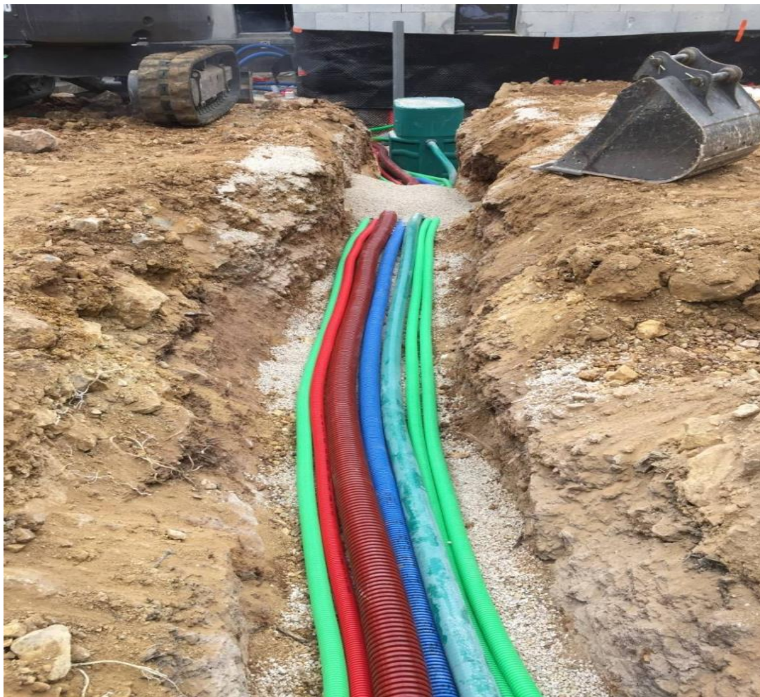
Fourreaux pour le passage des réseaux
