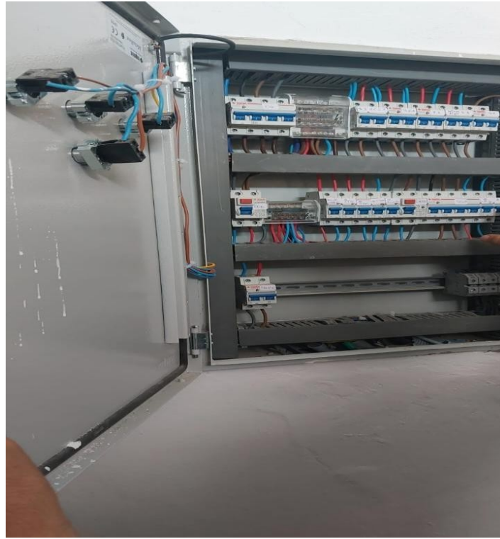
Figure 57: TES Contrôle du Tableau électrique secondaire
